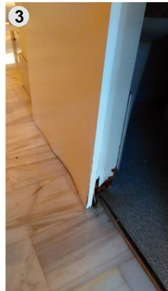
LA MALA CALIDAD DE LAS MISMAS O EL EXCESIVO PESO
